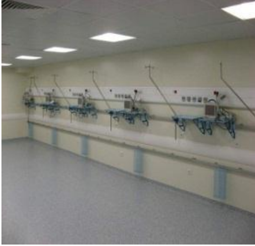
شكل رقم (٣-٤): صورة توضح تجهيزات وحدة الإفاقة
