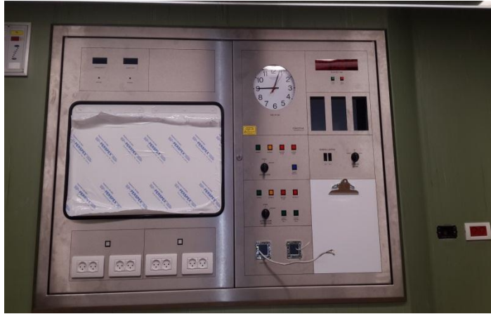
شكل رقم (٣-٢٠) صورة توضح لوحة التحكم الخاصة بالعمليات المصدر: الباحثة
